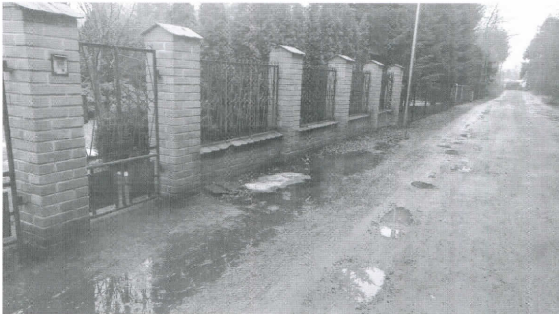
Fot. 6. Woda opadowa zalegająca na poboczu ul. Bizantyjskiej, widok w stronę drogi gminnej w Gminie Godziesze Wielkie
