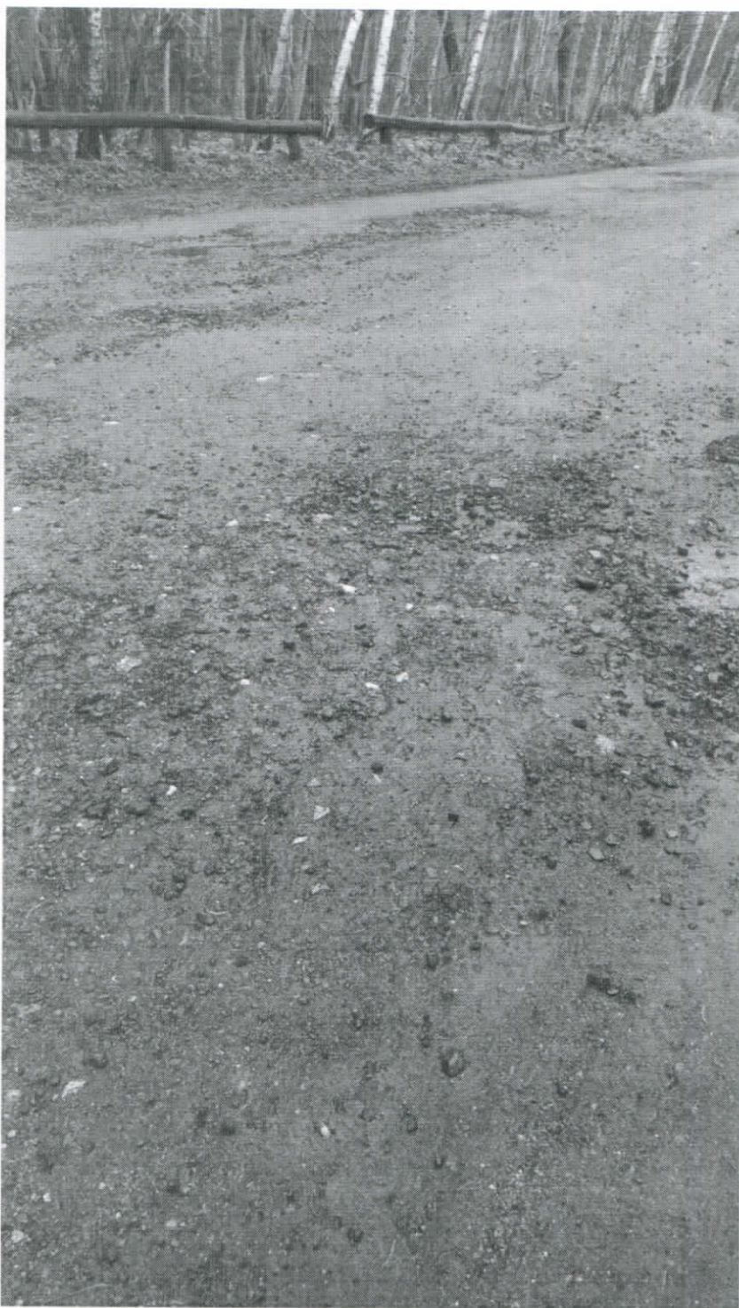
Fot. 2. Luźny destrukcyjny materiał pokrywający nawierzchnię ul. Bizantyjskiej
