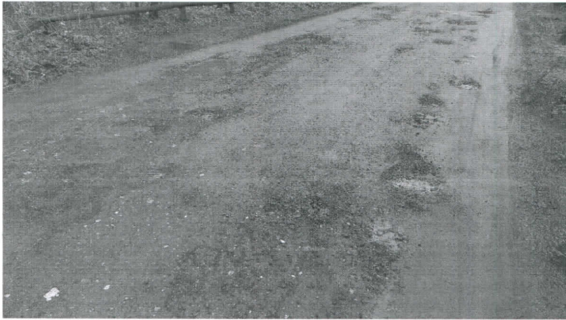
Fot. 5. Luźny materiał oraz liczne ubytki w nawierzchni ul. Bizantyjskiej
