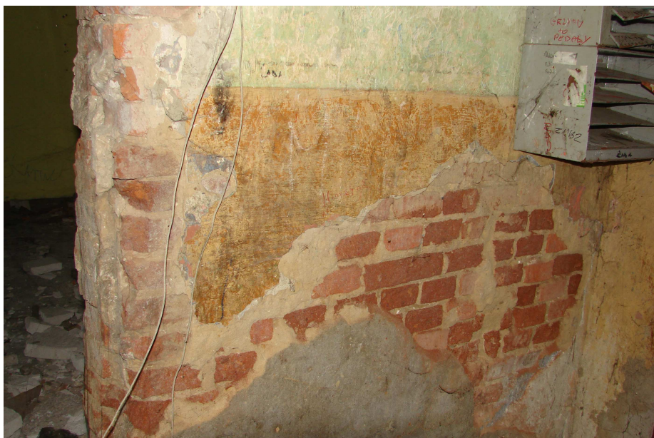
Nr 13. Zawilgocona ściana z odpadającym całymi płatami tynkiem wewnętrznym.
