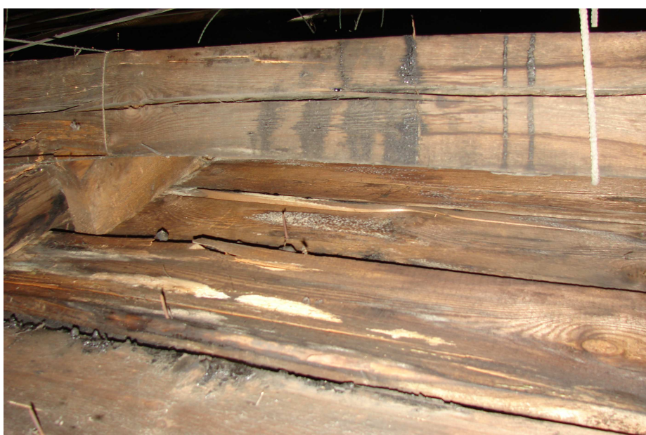
Nr. 22. Porażone grzybami i owadami drewniane krokwie dachowe.
