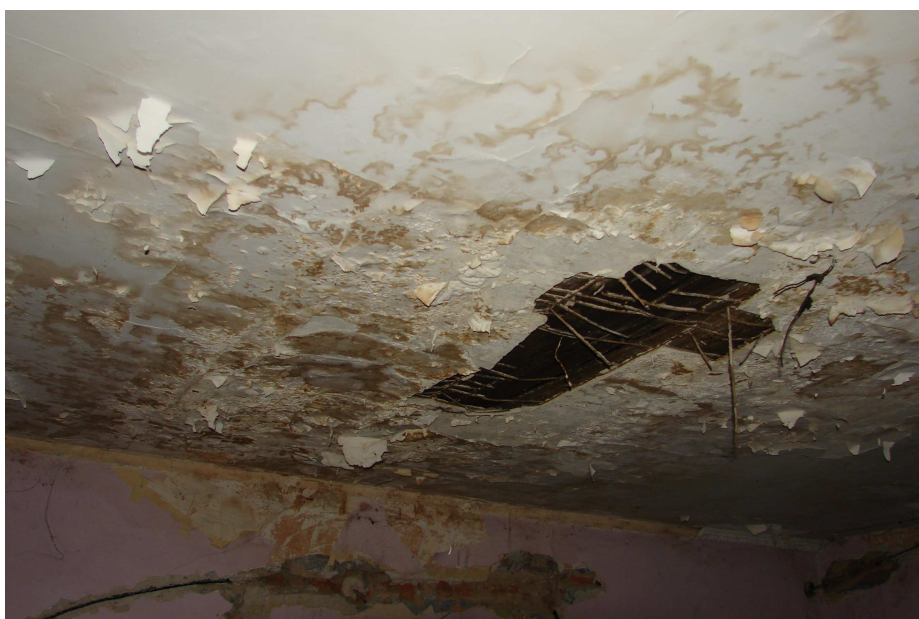
Nr. 15. Zamoczony, porażony grzybami i zarwany strop drewniany.
