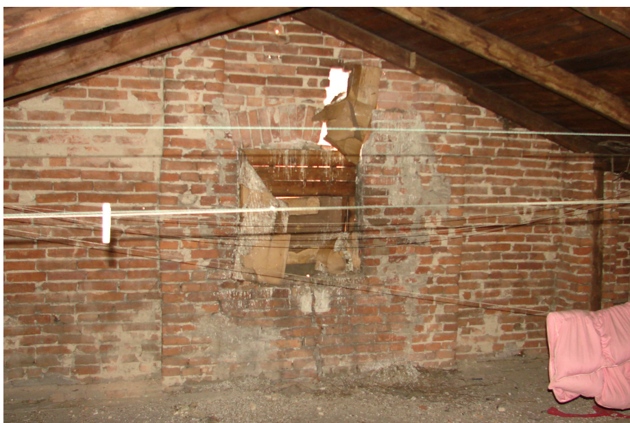
Nr. 19. Ściana szczytowa od wewnątrz brak części nadproża i muru nad nim.
