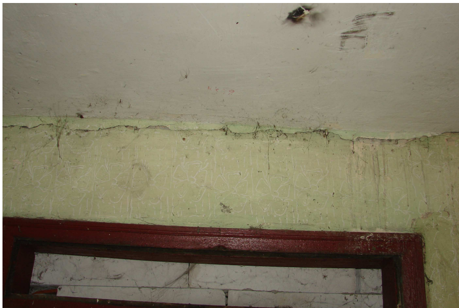
Nr.14. Oddzielający się strop drewniany od ściany nośnej.
