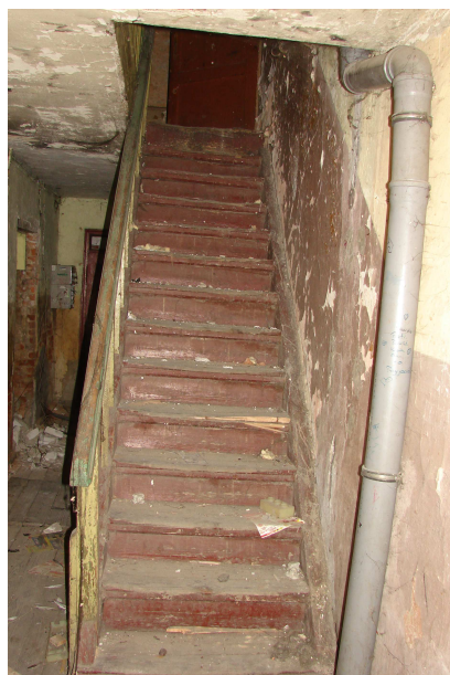
Nr. 30. Zużyte technicznie i porażone biologiczną korozją jednobiegowe schody drewniane na piętro.
