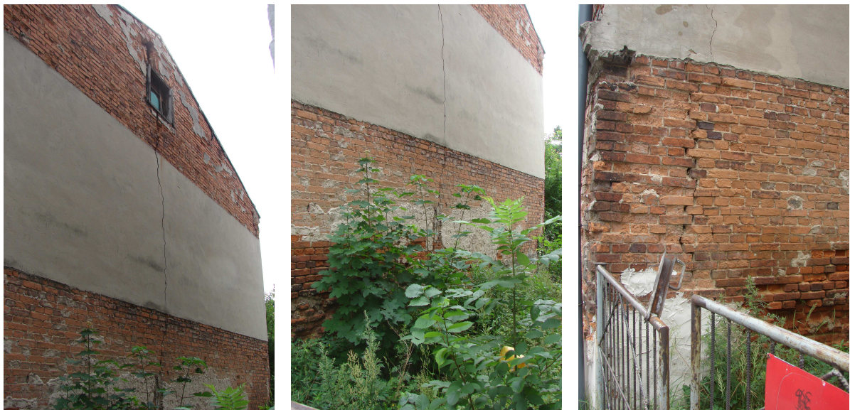
Nr 2. Ściana szczytowa od strony południowej spękana na całej wysokości oraz grubości w kilku miejscach i przesunięte spękane ściany względem siebie oraz wypaczone z pionu.
