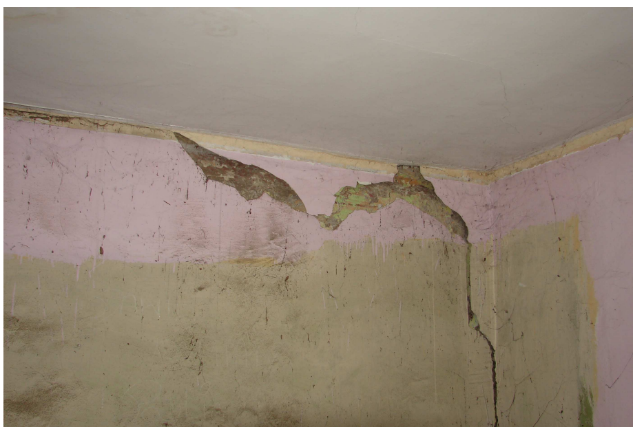
Nr. 18. Widok od wewnątrz odsunięcie ściany szczytowej od pionu na jej pęknięciu.
