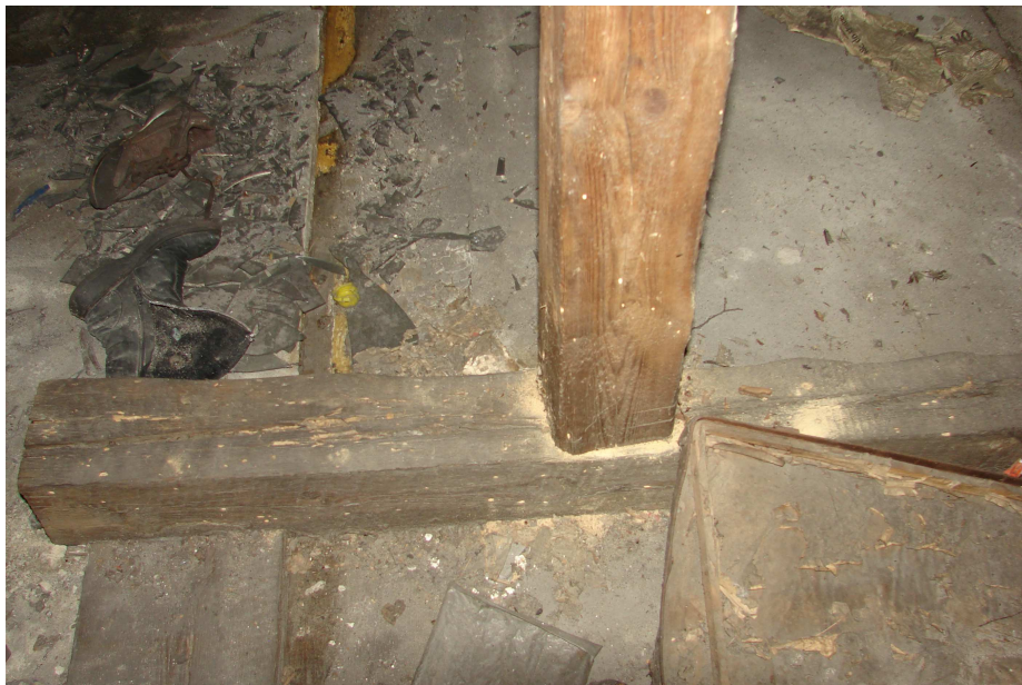
Nr. 23. Porażone owadami słup konstrukcji nośnej połaci dachowej.
