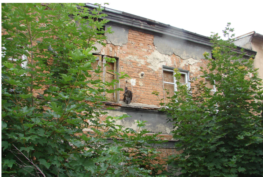
Nr 1. Elewacja tylna budynku, widoczne odpadanie tynku, zniszczona stolarka okienna.
