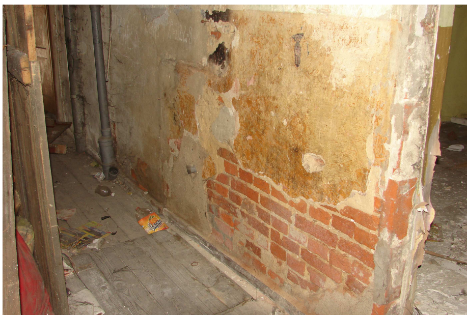
Nr 12. Zawilgocona ściana z odpadającym całymi płatami tynkiem wewnętrznym.
