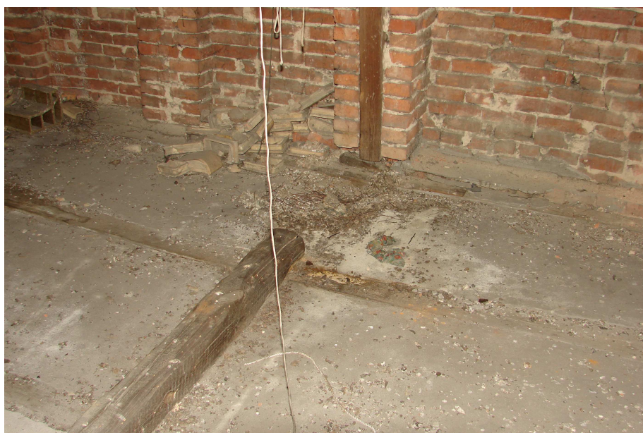
Nr. 24. Porażone grzybami i owadami drewniane belki stropowe.
