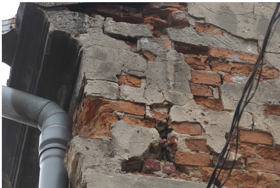
Nr 5, Spękany gzyms od strony południowo-zachodniej.
