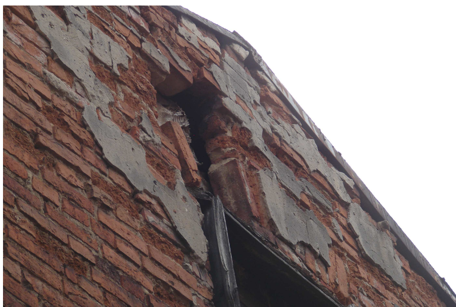
Nr 6. Spękane nadproże okienne od strony południowo-zachodniej.
