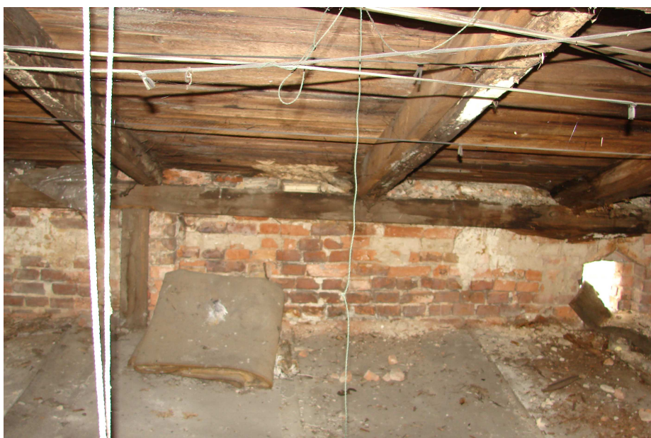
Nr. 21. Porażone grzybami drewniane krokwie dachowe.
