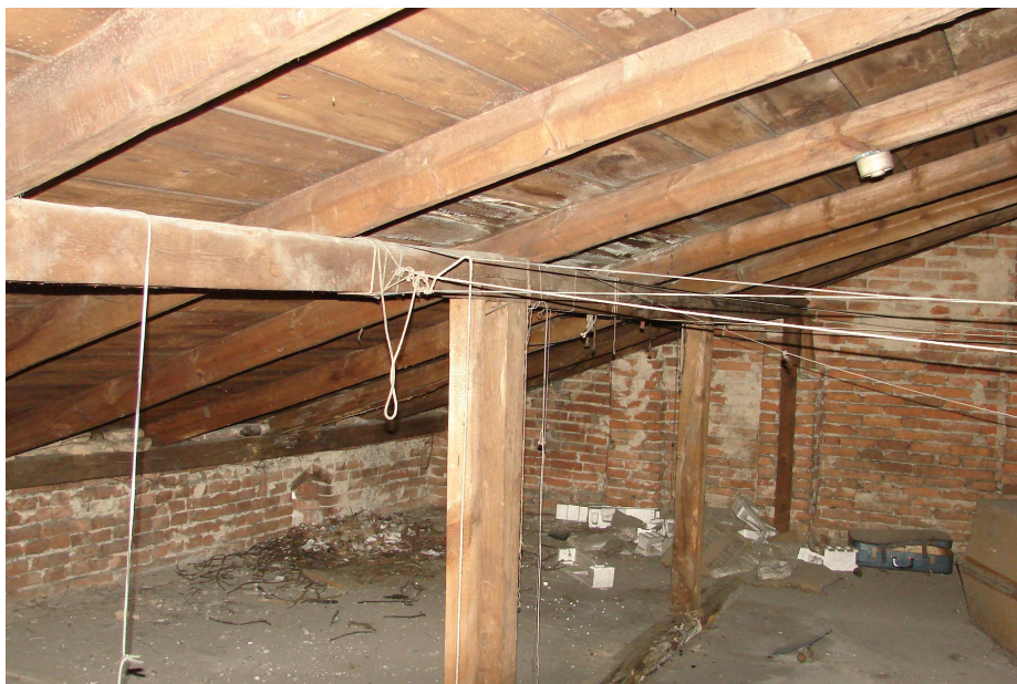
Nr. 20. Porażone grzybami deski poszycia dachowego.
