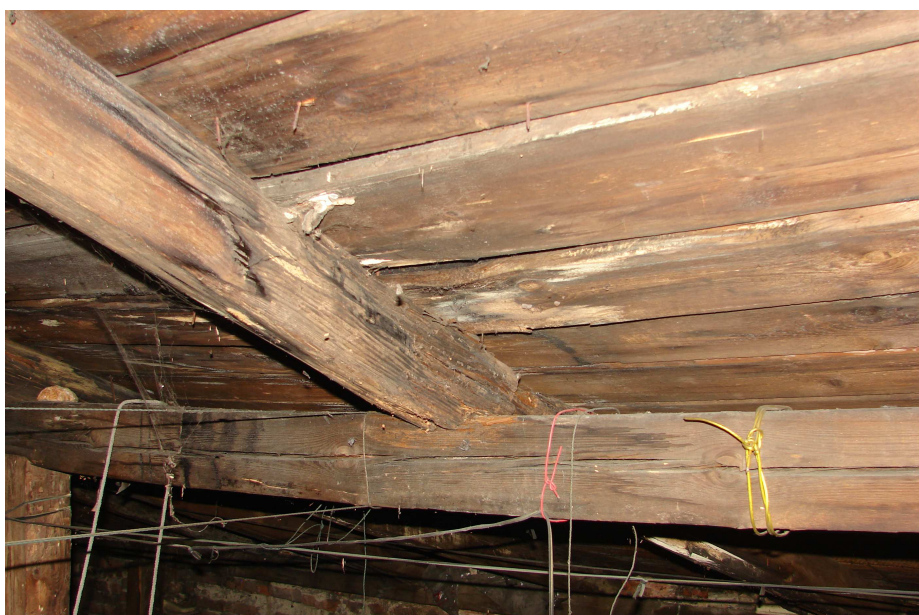
Nr. 25. Porażone owadami i grzybami krokwie oraz płatwie co spowodowało ich nadmierne ugięcie przekraczające dopuszczalne normą.
