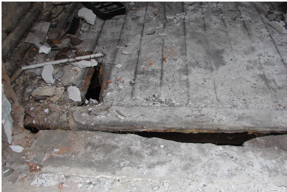
Nr. 29. Wejście drewniane do częściowego podpiwniczenia pod korytarzem zużyte i porażone biologicznie elementy drewniane.
