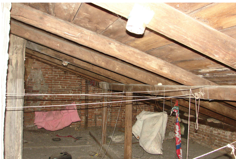
Nr. 28. Ugięcie drewnianej skorodowanej płatwi przekraczające dopuszczalne normą.
