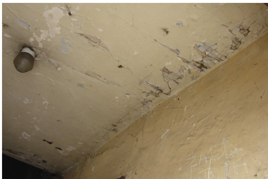
Nr 10. Odpadający tynk od zamoczonych desek sufitowych na drewnianym stropie.
