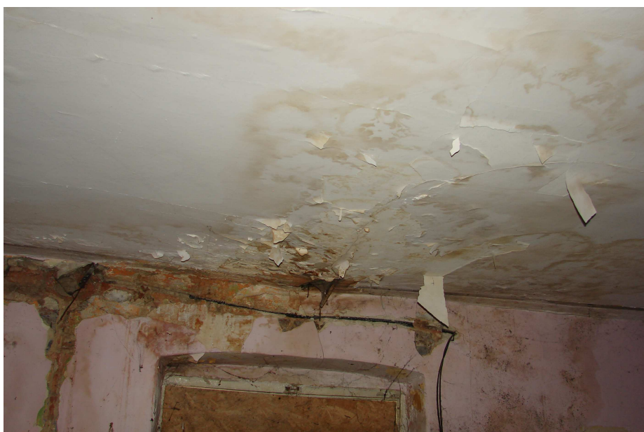
Nr. 16. Zamoczony, porażony grzybami i zarwany strop drewniany.
