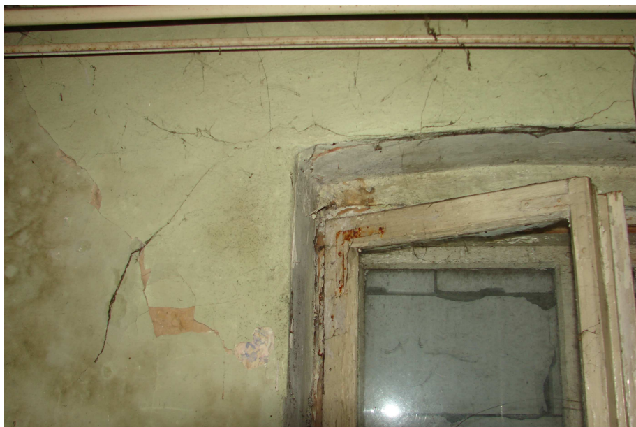
Nr 11. Spękana ściana i zużyta technicznie stolarka okienna.
