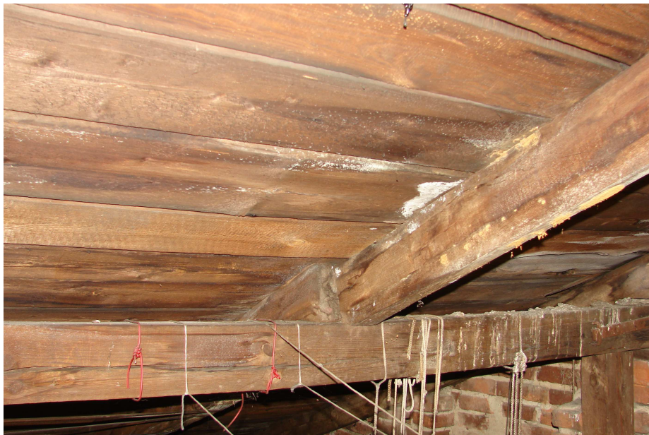
Nr. 26. Porażone owadami i grzybami krokwie oraz płatwie i deski poszycia dachowego co spowodowało ich nadmierne ugięcie przekraczające dopuszczalne normą.
