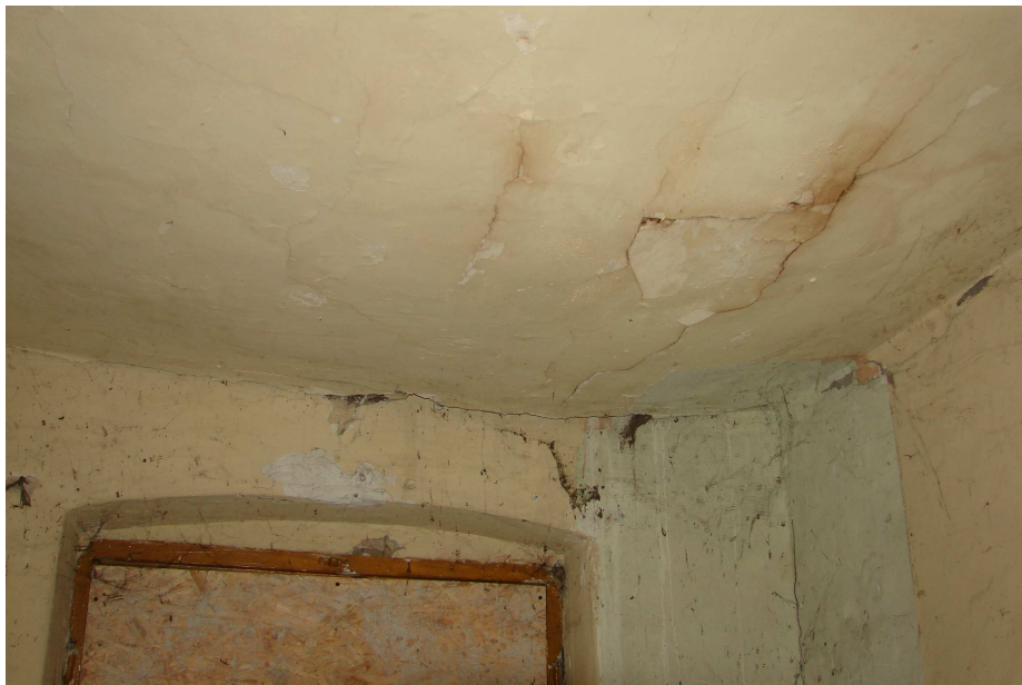
Nr. 17. Zamoczony, porażony grzybami i zarwany strop drewniany.
