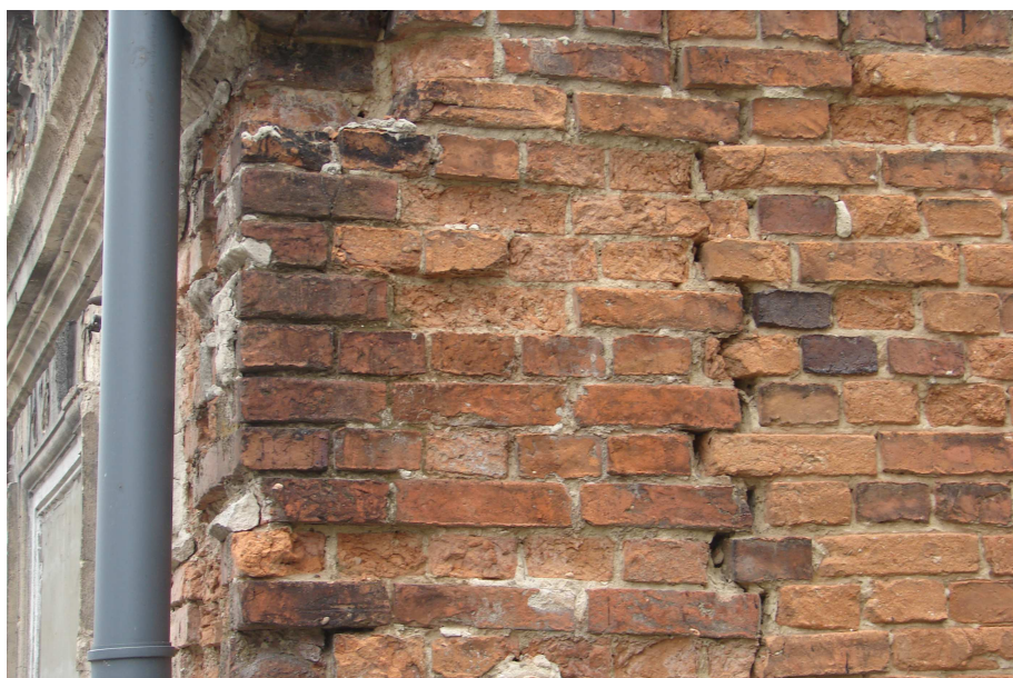
Nr 4, Spękana w pionie ściana szczytowa południowa.
